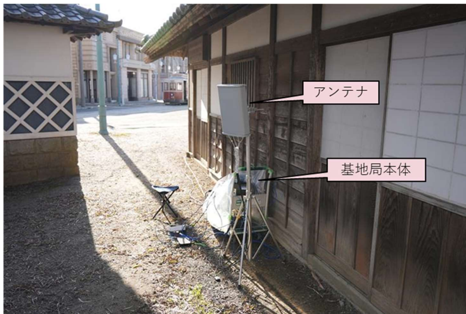
図 3-27 基地局(DAS なし)設置写真(再掲)
