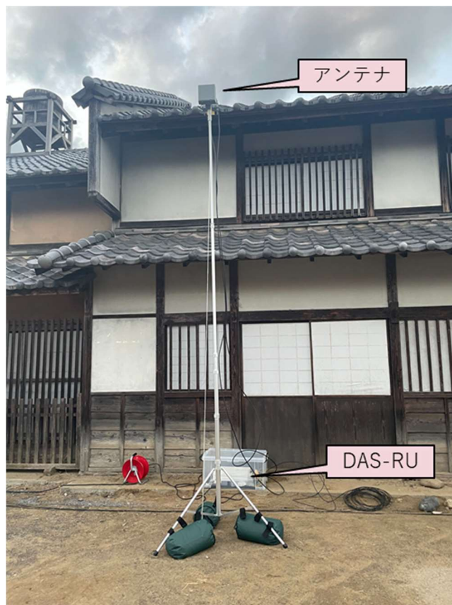
図 3-29 大店通り(DAS-RU①)アンテナ設置写真(再掲)
