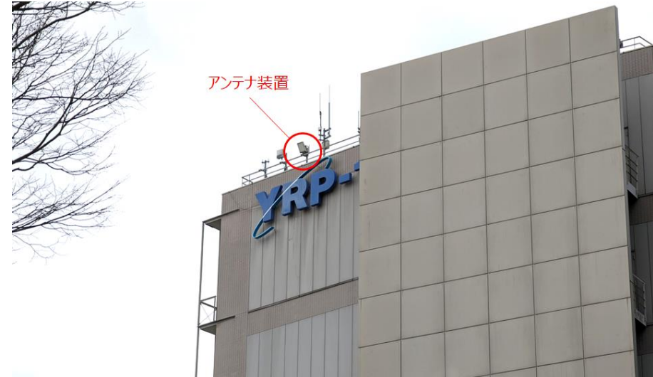
アンテナ装置の設置状態
