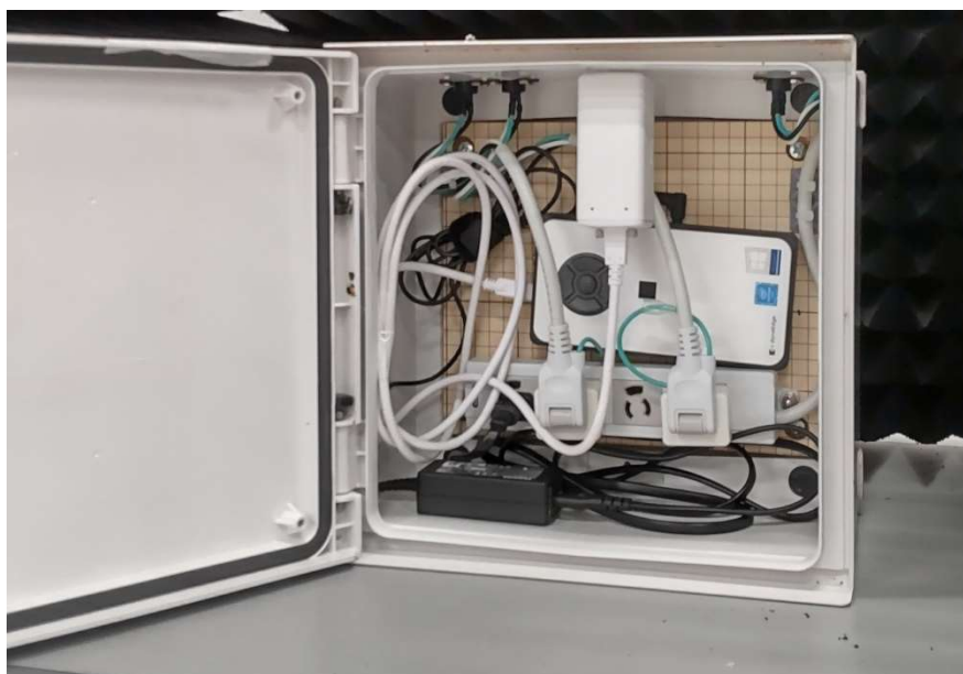
図 4-47 ハウジングケース内に端末システムを設置した状態 ※4
