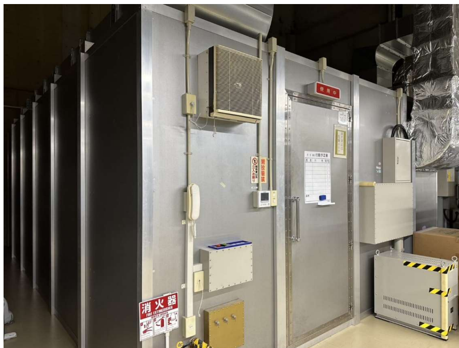
図 2.2-5 FCNT 本社実験室内のシールドルーム
