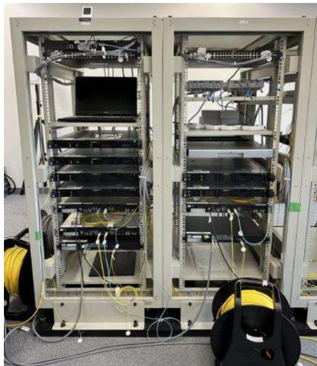
図 3.2-6 制御装置の設置環境
