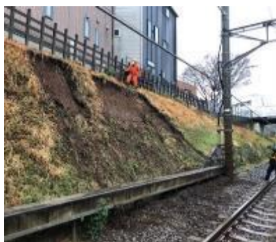
沿線の法面崩壊
