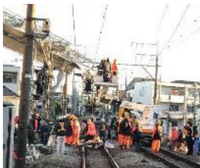
近隣工事現場の工事用足場倒壊
