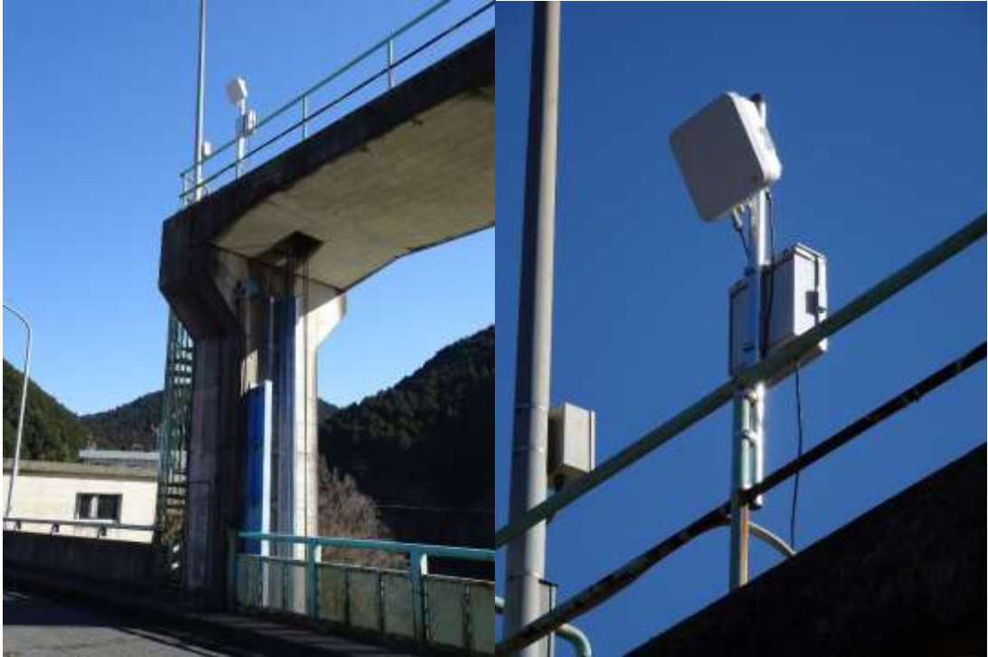
図 2-9 クレストゲート上に設置した下流向き無線ユニット(RU1)
