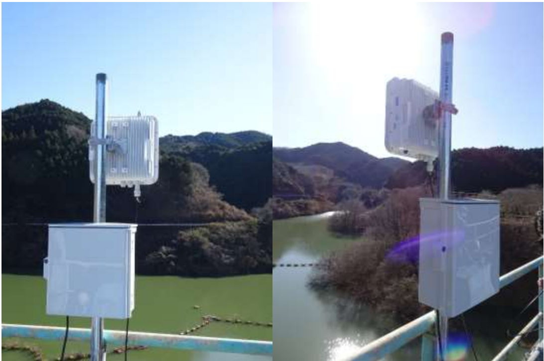
図 2-10 クレストゲート上に設置した上流向き(ダム湖側)無線ユニット(RU2)
