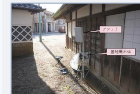
上図：基地局設置状況
