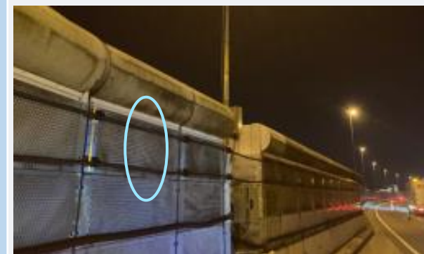
漏洩同軸ケーブル ※遮音壁に据付
