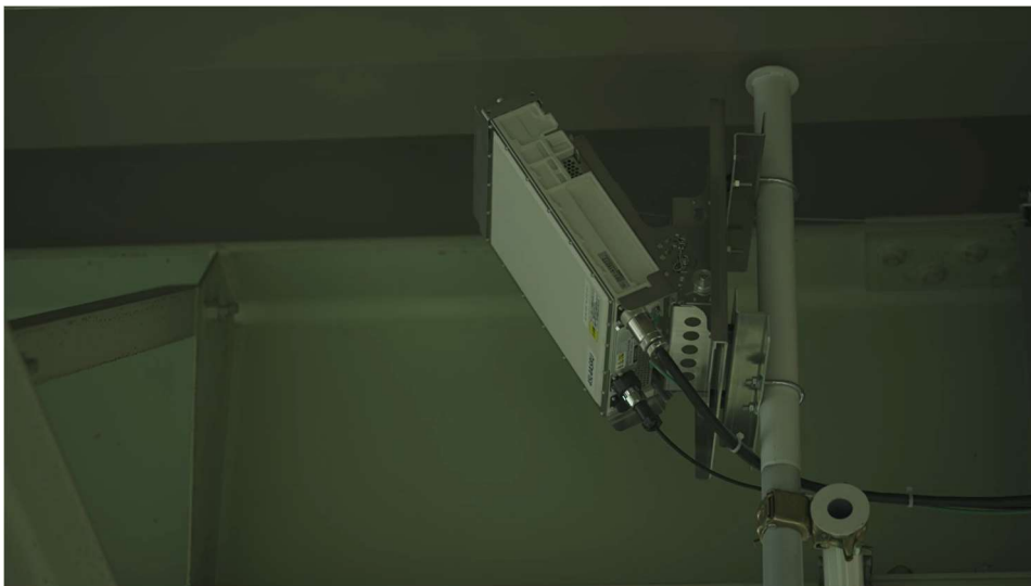
図 4-11 2 階に設置した 5G 基地局
