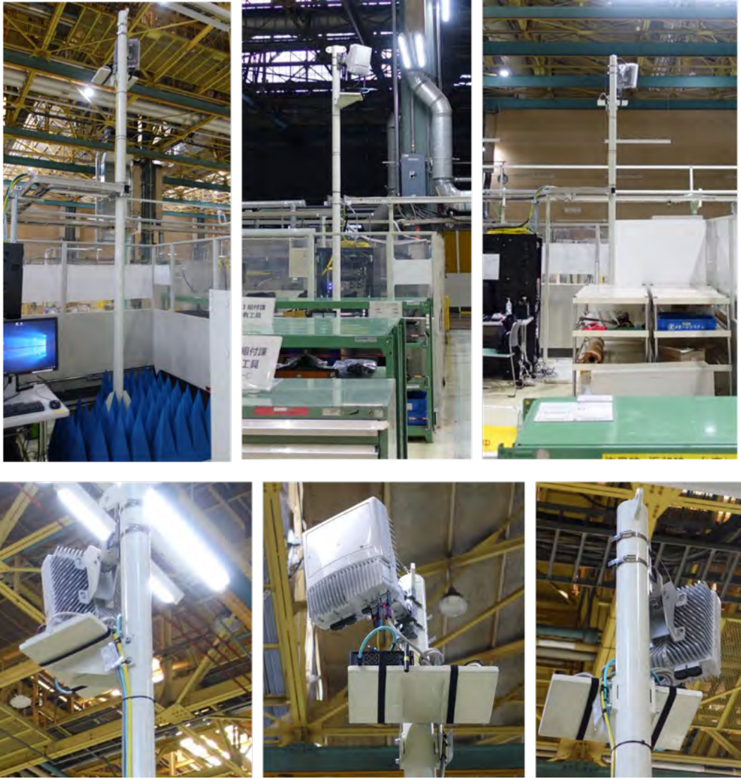
図 3-8 アンテナ支柱 A
