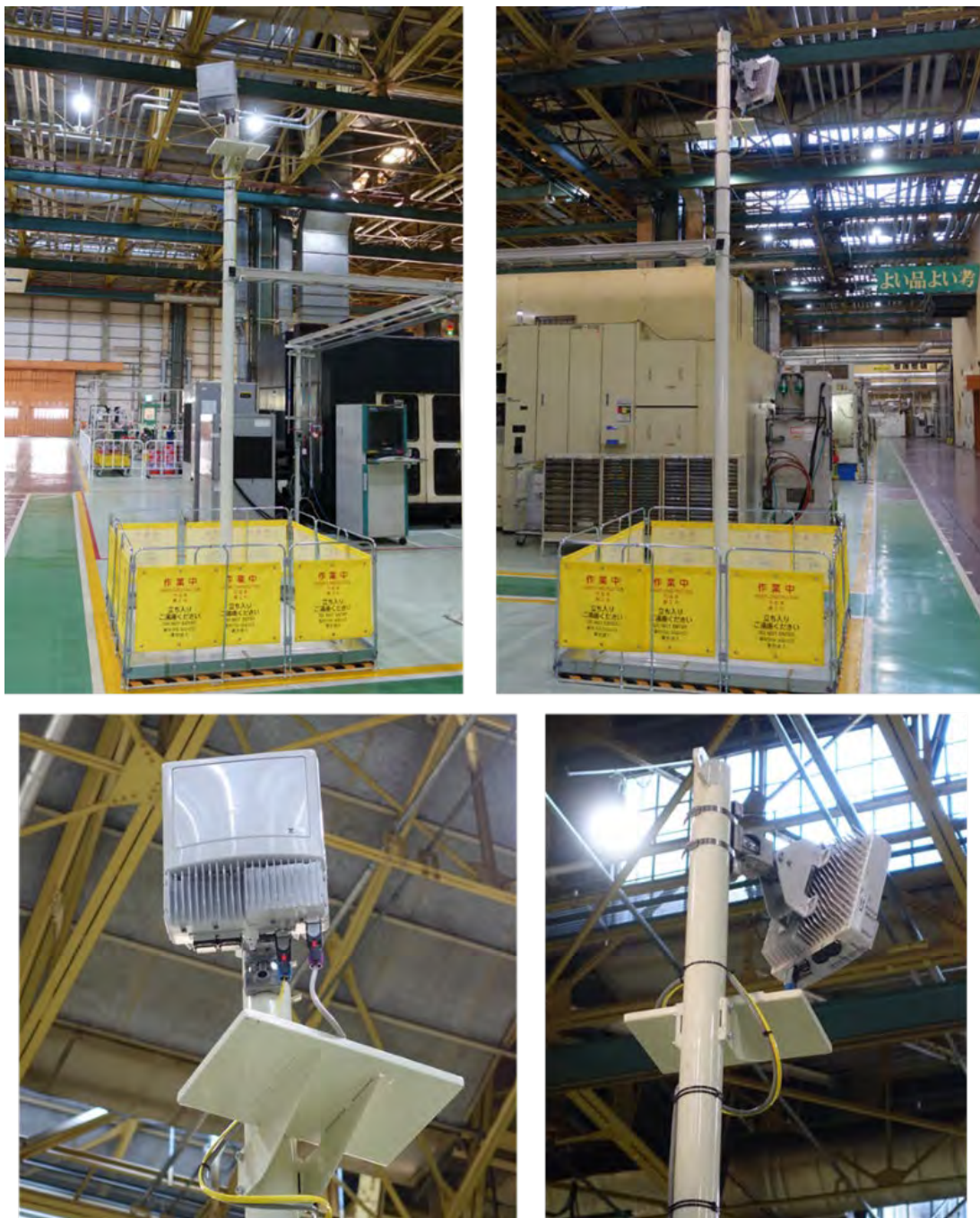
図 3-4 アンテナ支柱 B
