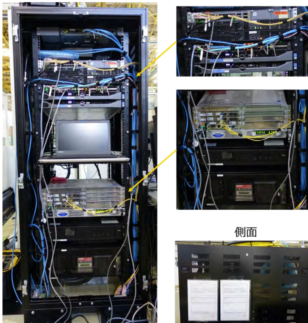
図 3-6 機器収容ラック
