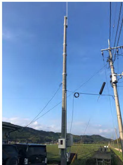
図 3.1-4 コンクリート柱に設置した機材
