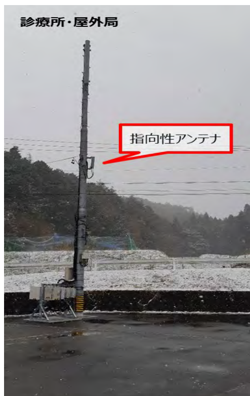
図 5.1.2-1 (b) 屋外基地局設置状況 診療所技術実証試験フィールド
