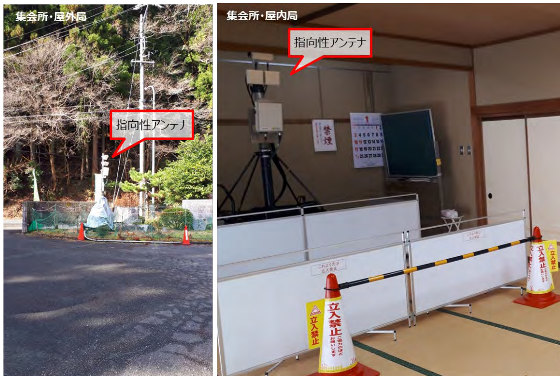
図 5.1.2-2 (b) 基地局設置状況 (左：屋外基地局、右：屋内基地局) 集会所技術実証試験フィールド
