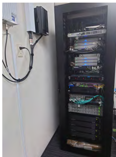
図 2-2 施錠可能な機器設置ラック
