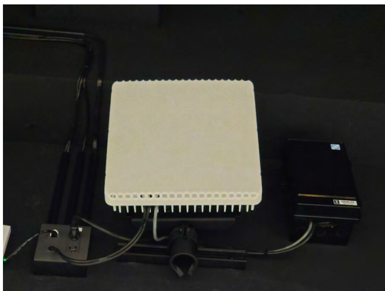
図 1-1 基地局の設置風景
