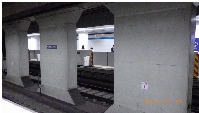
図 5.4.1.3-8 両ホーム間の中柱およびホームドアの様子
