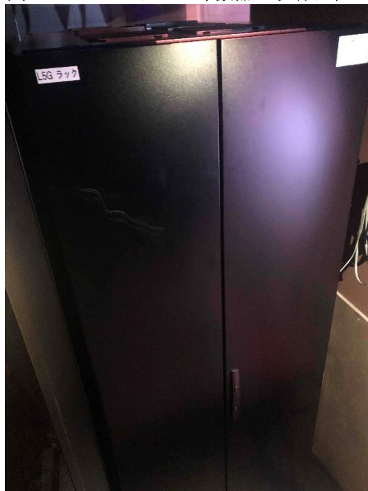
図 4-75 ネットワーク・サーバ等機器の収容ラック（鍵付き）
