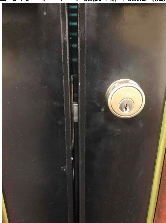
図 4-74 e スポーツ施設の扉の施錠 (鍵)
