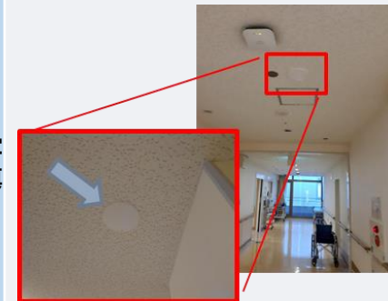
病院内DASアンテナ
