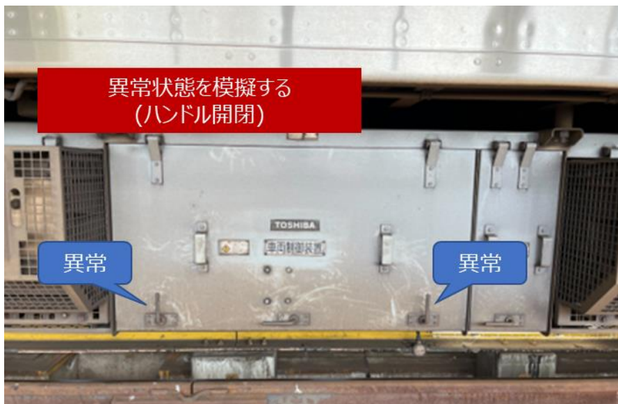
図 3. 3. 1-7 収容函ハンドルの開閉異常検知場所
