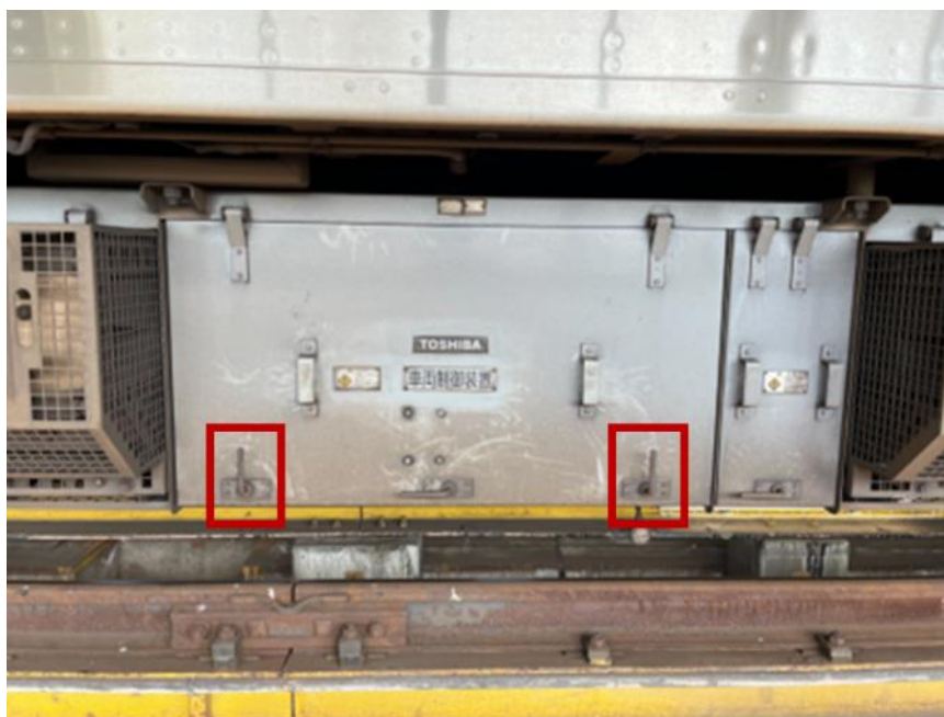
図 3. 2. 2-16 収容函ハンドルの開閉場所
