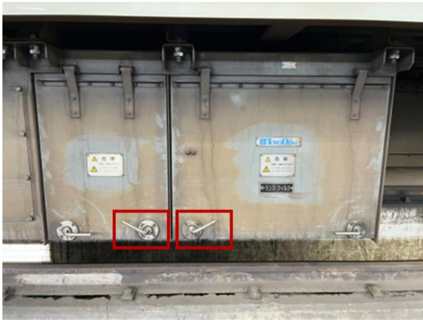
図 3. 2. 2-27 収容函ハンドルの開閉場所
