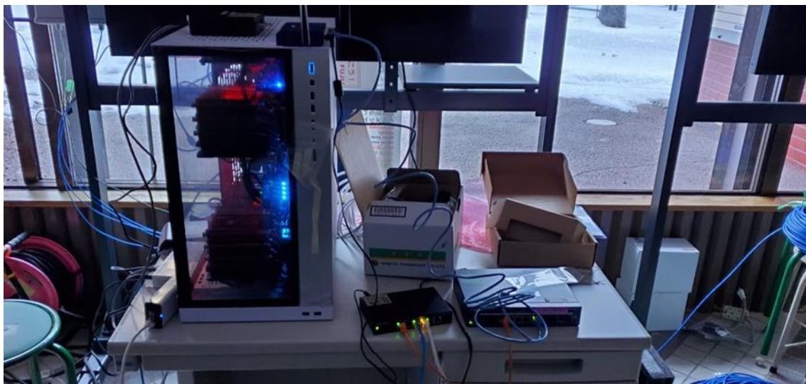
図 2-9 5 合目に設置した一体型基地局 (FLARE 基地局) とネットワーク機器 (VPN ルーター)
