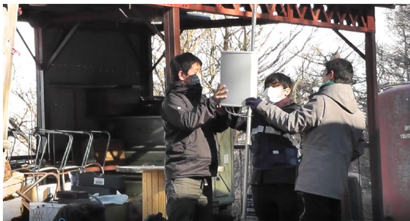
図 5-2 ローカル 5G のアンテナ・基地局を設置する様子_5 合目佐藤小屋前
