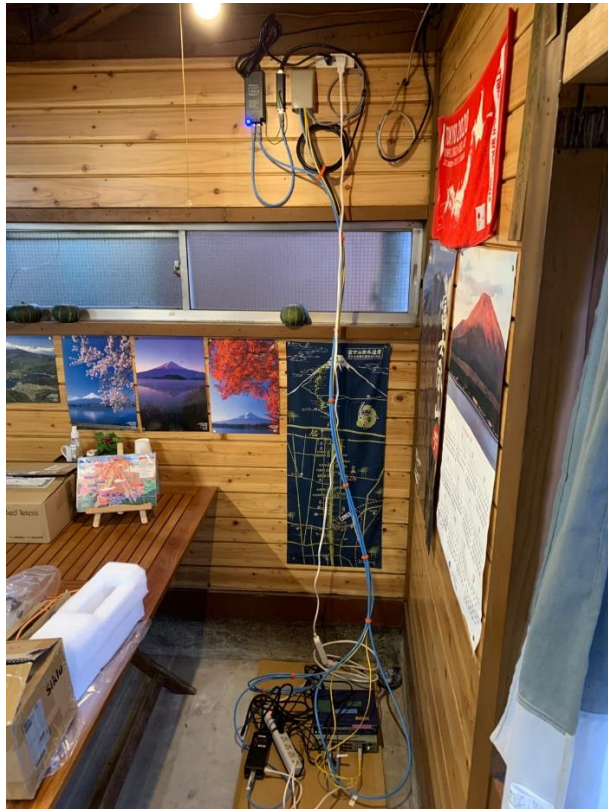
図 2-11 佐藤小屋に設置したネットワーク機器 (L3-SW/VPN ルータ)
