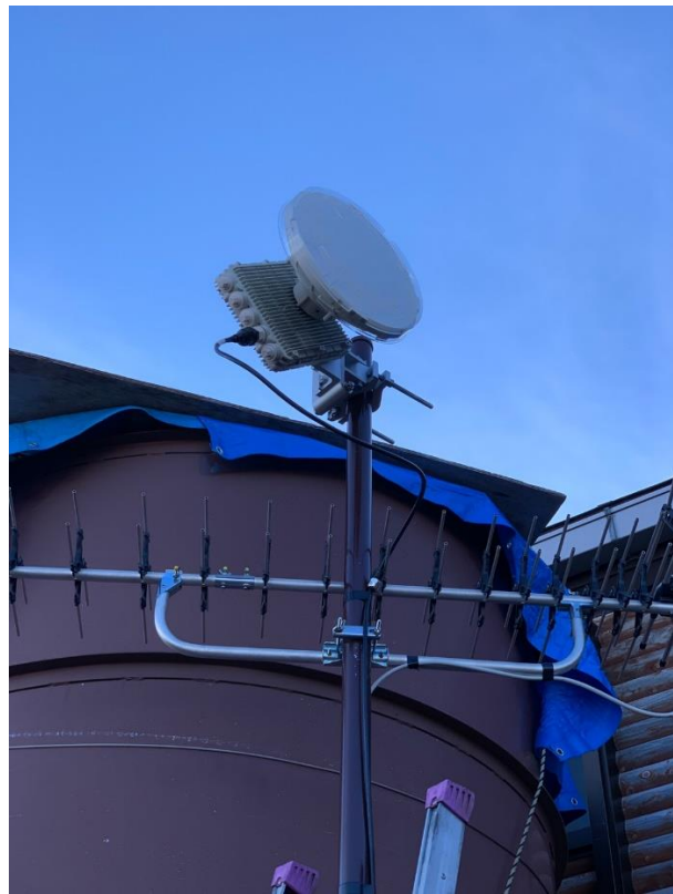
図 2-12 佐藤小屋に設置した 5 合目向け FWA
