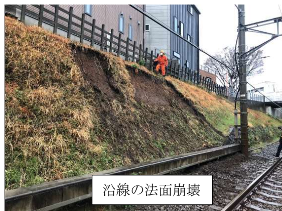
図 4.4.1.1(3) -3) 沿線の法面崩壊
