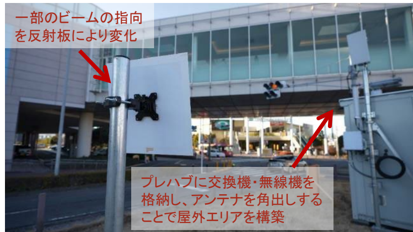
ローカル5G基地局等の設置状況
