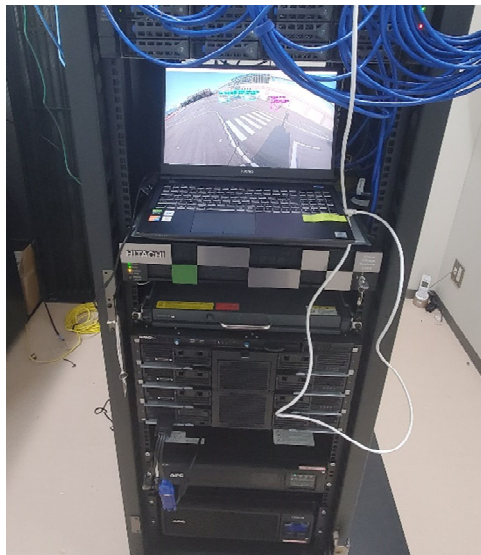
図 4-52 サーバー室における伝送された映像の様子
